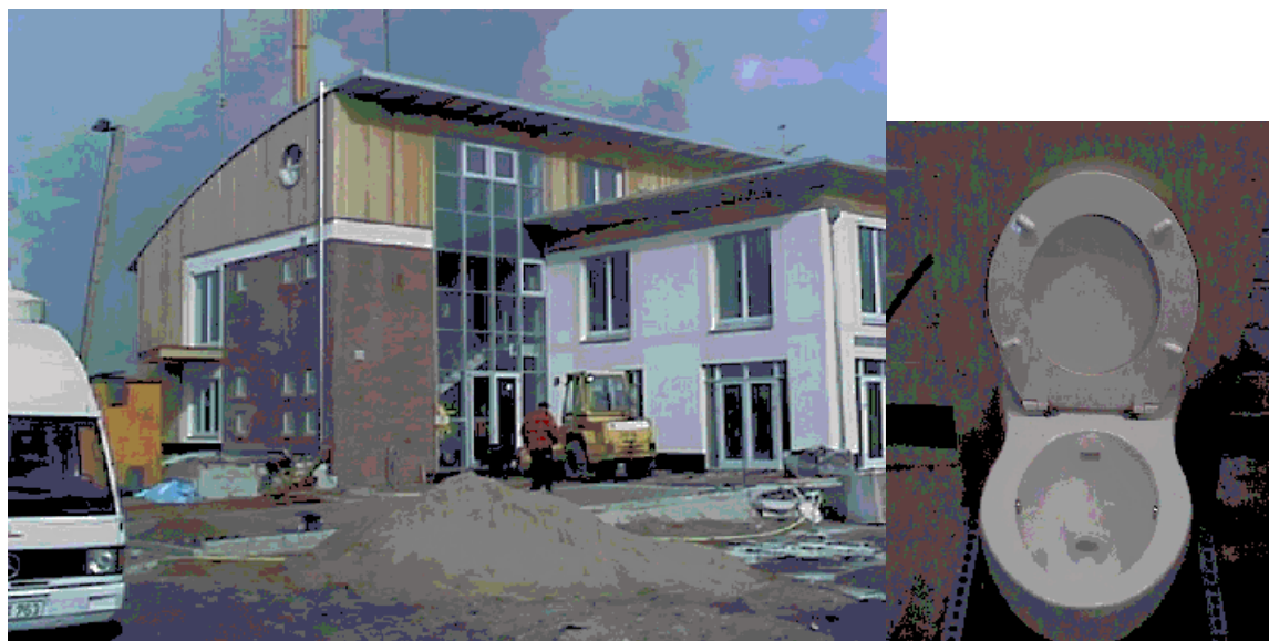
Diagrama 9.4 (izquierda) El edificio comunitario en el asentamiento de Flintenbreite; (derecha) Un sanitario a vacío que utiliza un litro de agua por descarga.
